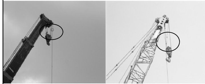
設置過捲揚裝置
