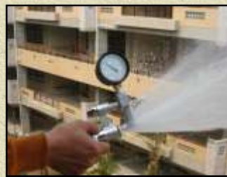
實際放水測試情形
